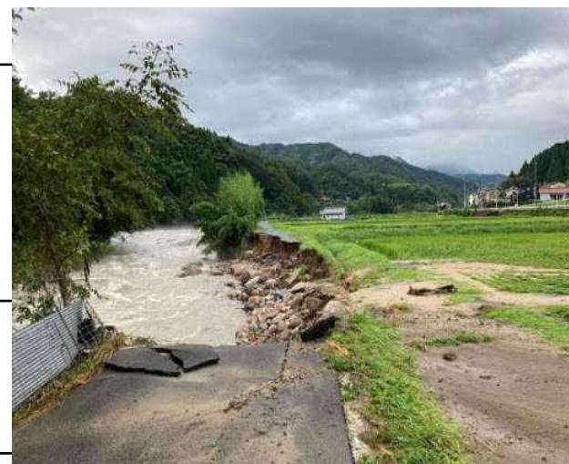
<農道が崩落し土砂が流入した水田(三朝町助谷)>
